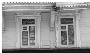
Плохо. Реклама полностью заполняет оконные проемы
